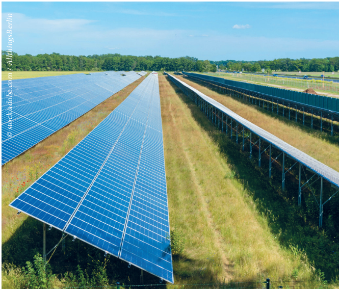
Solarpark an der A10 in Brandenburg (Beispielbild).
